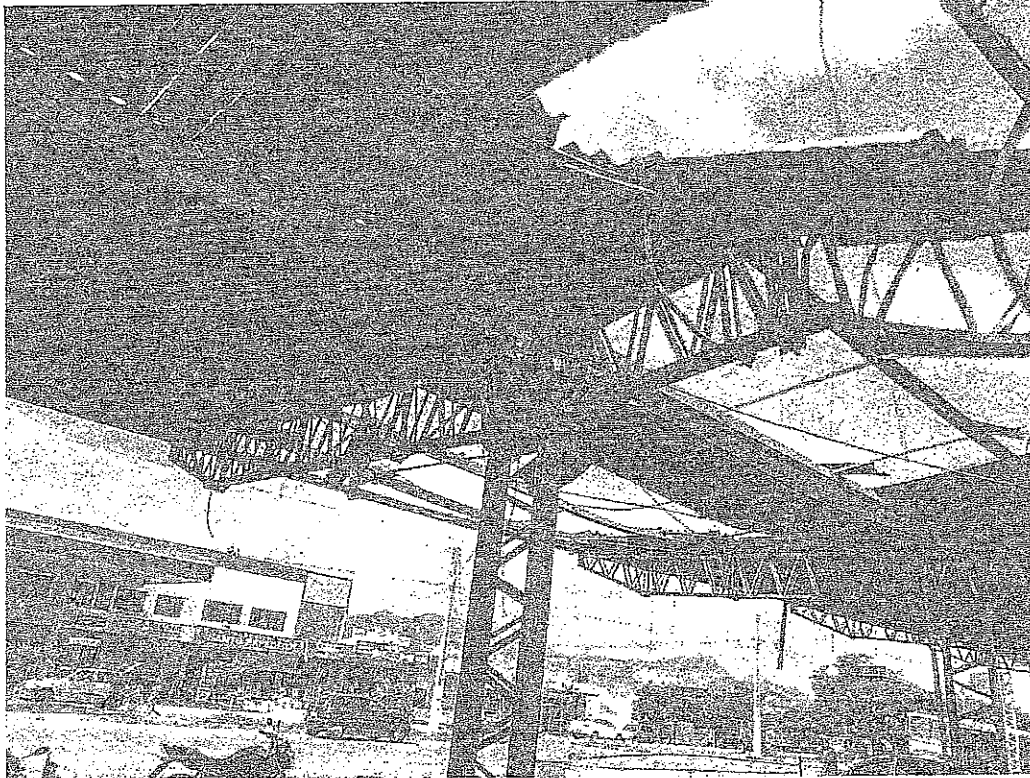
DETALHES DAS VIGAS E TERÇAS DANIFICADAS
